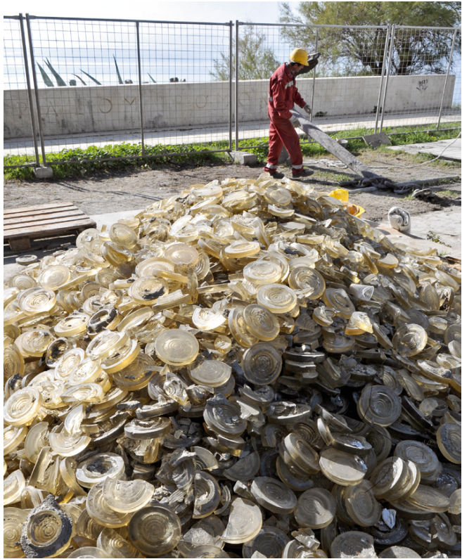
Stare i oštećene staklene prizme su izvađene, a na gradilištu se praši na sve strane
